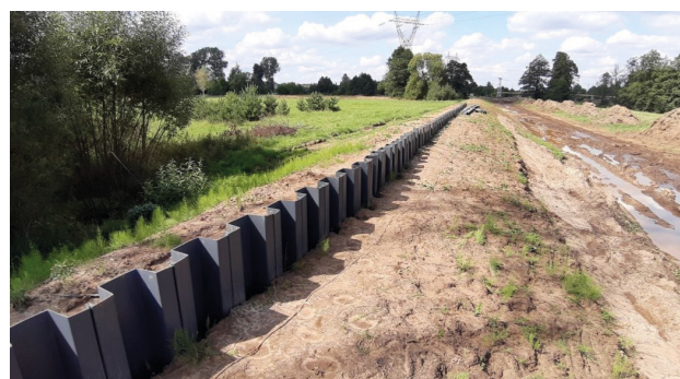
Wzmocnienie wałów przeciwpowodziowych za pomocą systemu grodzic winylowych Ecolock w Częstochowie, fot. Pietrucha Int.
